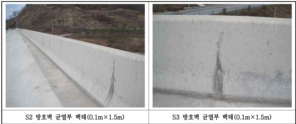
【사진 3.3.24】 방호벽 및 중앙분리대 손상현황
