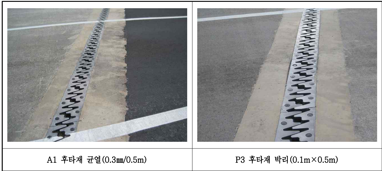
【사진 3.3.17】 신축이음장치 손상현황
