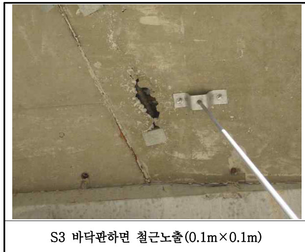
【사진 3.3.28】 바닥판하면 손상현황
