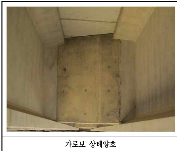
【사진 3.3.7】 가로보 손상현황
