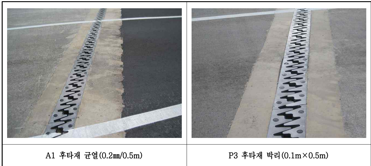
【사진 3.3.43】 신축이음장치 손상현황
