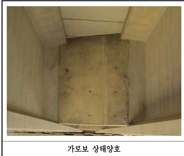
【사진 3.3.32】 가로보 손상현황
