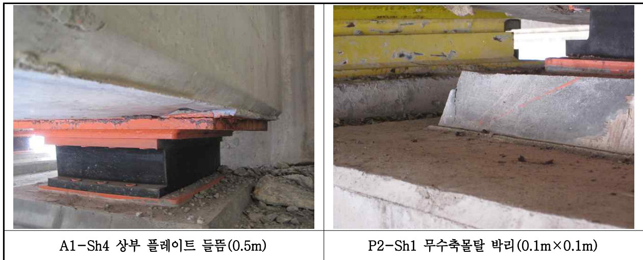
【사진 3.3.39】 교량받침 손상현황(계속)
