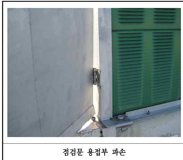
【사진 3.3.52】 교량 점검시설 손상현황
