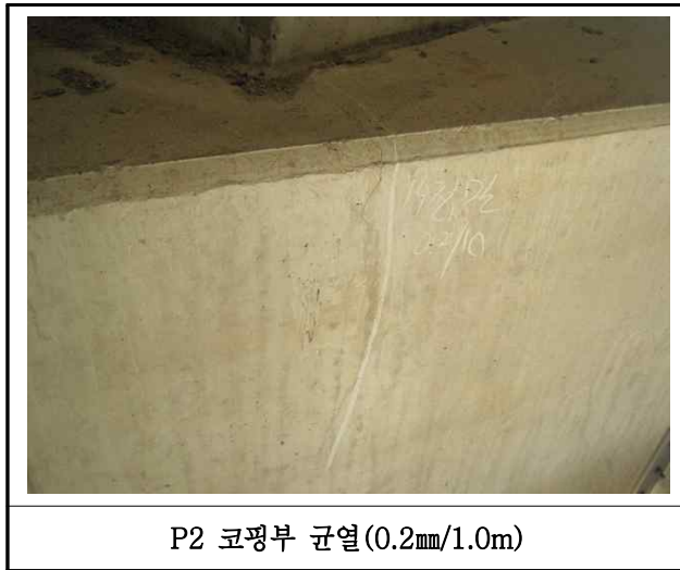
【사진 3.3.36】 교각 손상현황
